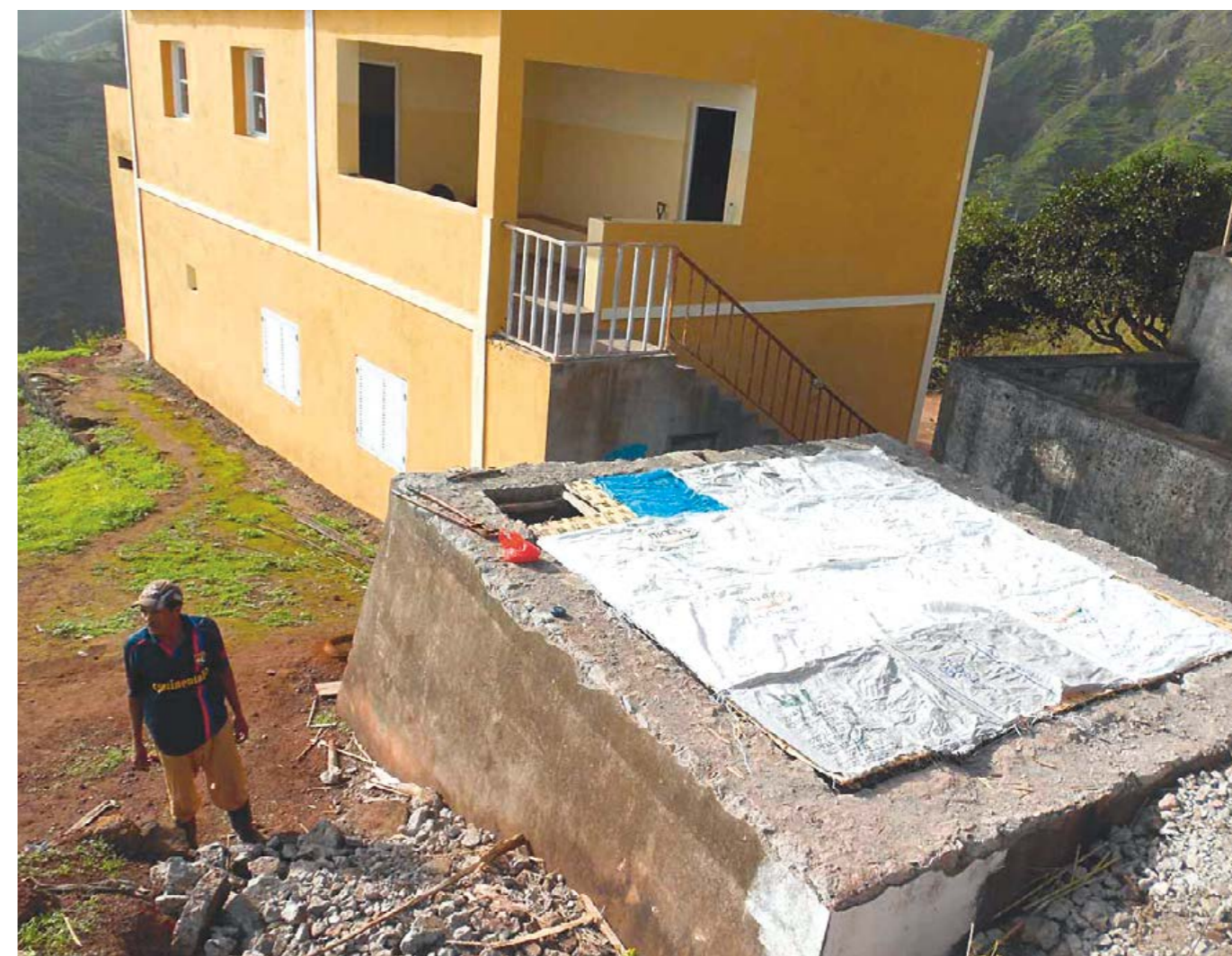
Die Schule von S. Isabel: Neben der Zisterne (vorn im Bild) wurde auch das Schulhaus im Hintergrund renoviert.
